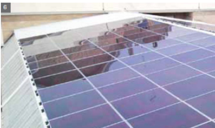
6. L'installation est opérationnelle.
